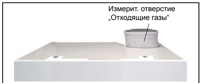
Рис.: Измерение отходящих газов на котле с одетой обшивкой
